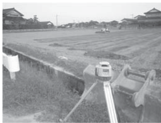
レーザーマシン 設置状況
