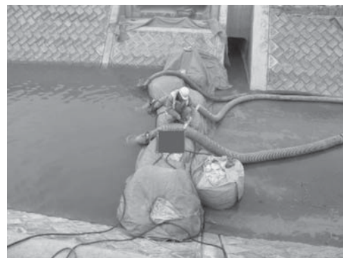
写真—9 ポンプ運転状況
