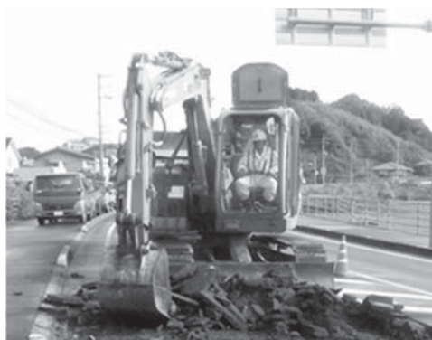
写真—4 舗装版破碎状況
