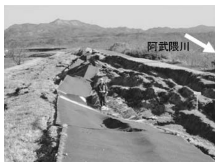
写真—1 河川堤防の液状化被害
