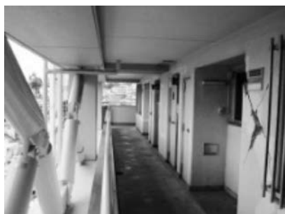
写真—5 制振補強したにもかかわらず被災した建築物
