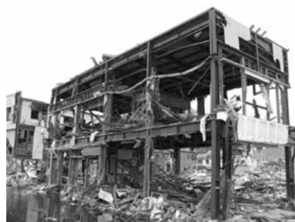
写真—3 外壁材が全面的に流失した建築物
