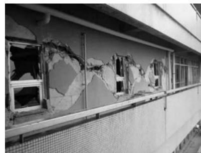
写真—2 鉄筋コンクリート造建築物の非構造壁被害
