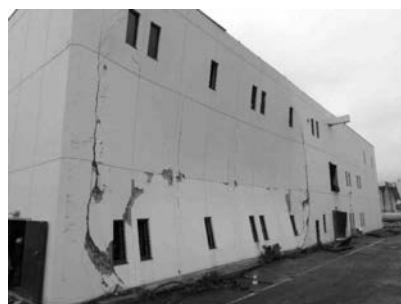
写真—1 津波による鉄筋コンクリート造外壁被害
