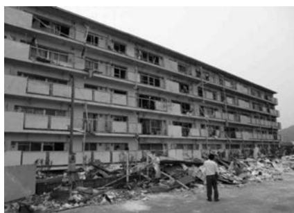
写真—7 被災した鉄筋コンクリート造建築物
