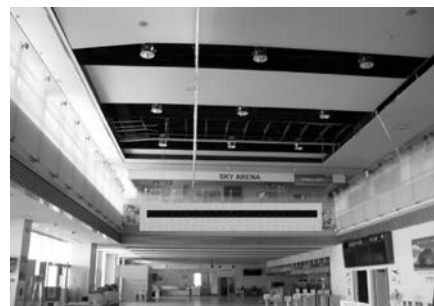
写真—6 新耐震建築物の天井被害事例
