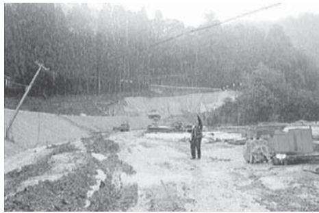
写真一2 架空線が引っ張られ電柱が折れる
