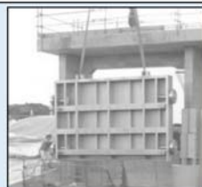
新設のステンレス水門
