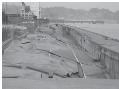
写真一 護岸の倒壊・背後地盤の沈下 (小名浜港)
