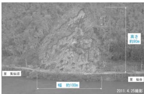
写真—2 被災状況
