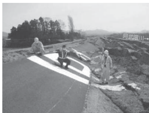
写真—4 阿武隈川下流被災状況 (宮城県角田市枝野)
