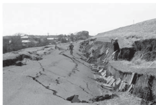
写真—3 利根川下流被災状況 (千葉県栄町三和地先)
