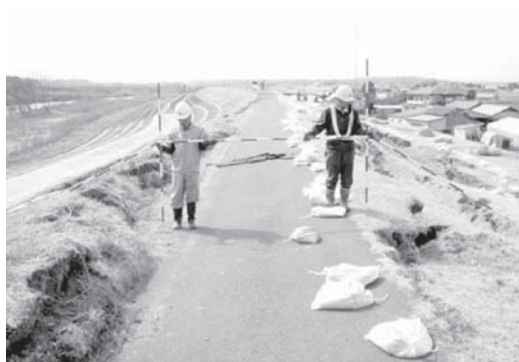
写真一10 吉田川被災状況 (宮城県大崎市鹿島台大迫上志田地先)
