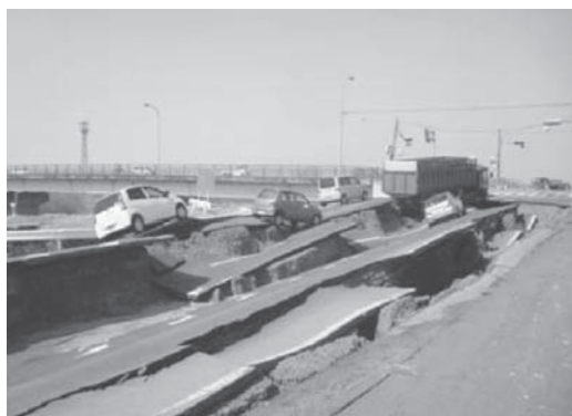
写真—1 江合川被災状況 (宮城県大崎市古川湊尻地先)
