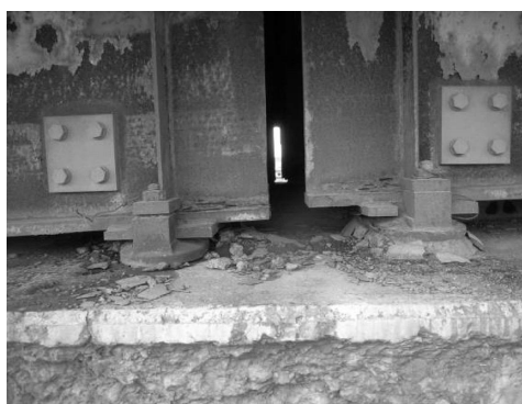
写真—1 支承の台座コンクリートの破損
