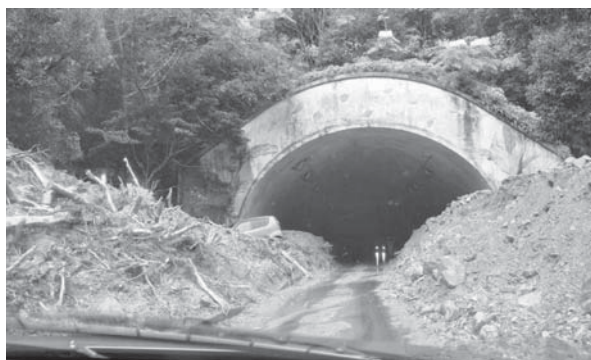
写真—5 大和村大和浜 土砂流入により通行止め。土砂を除去し、1車線確保
