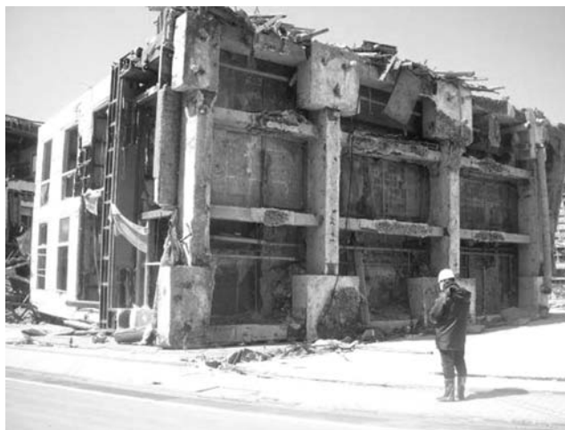
写真－1 津波による建築物の被害調査状況 (平成23年4月，宮城県女川町)
