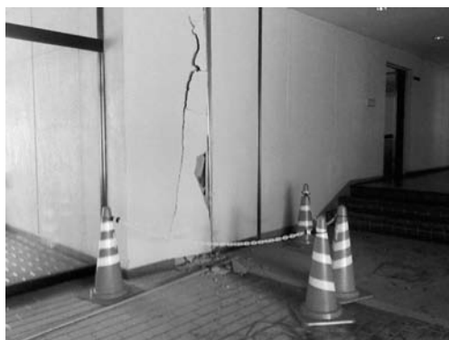
写真－2 管理研究本館の高層部・低層部接続部分の壁等の破損
