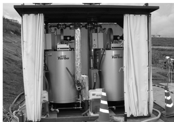
写真-1 蒸気ボイラー
