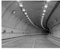
トンネル照明設備
