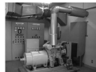
非常用発電設備
