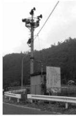
放流警報設備
