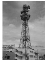
無線通信設備
