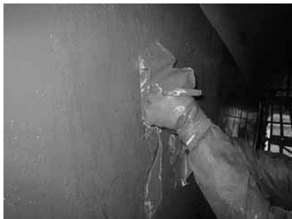
写真-2 塗膜剥離状況
